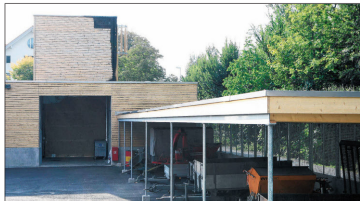
Die Steffisburger Altstoffsammelstelle: Beim Brandanschlag in der Nacht auf Samstag wurde die Holzfassade beschädigt.
